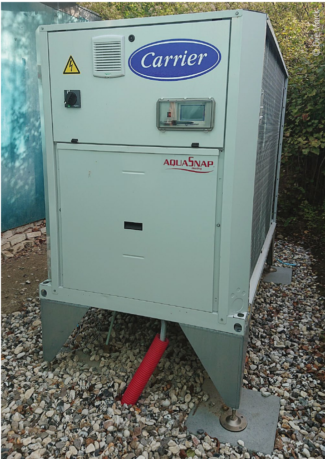
Die Luft-Wasser-Wärmepumpe trägt, intelligent gesteuert, wesentlich zum Erfolg des Sanierungskonzepts bei
