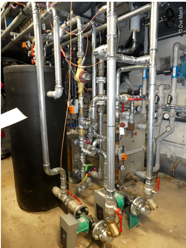
Neuer Wärmetauscher an der Fernwärme- und Rohrinstallation zur Einleitung von Wärme aus der Wärmepumpe
