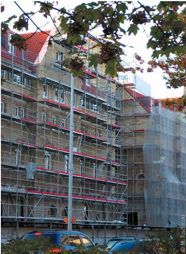
Abb. 1: Nach der energetischen Sanierung der Gebäudehülle muss der Eigentümer nur dann der Behörde eine Erfüllungserklärung nach GEG vorlegen, wenn der Nachweis anhand des gesamten geänderten Bestandsgebäudes erfolgt
