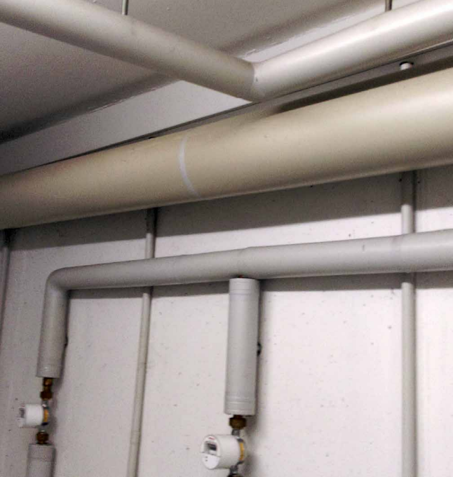
Abb. 2: Zu den Nachrüstpflichten im Baubestand zählt auch die Wärmedämmung von Leitungen und Armaturen, die Wärme durch unbeheizte Zonen führen. Foto: M. Tuschinski
